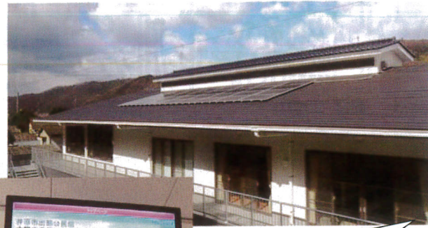
屋根には8KW/hの太陽光発電装置を設置
