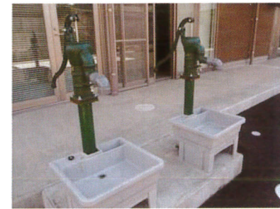
災害時の準備として設置した手押しポンプ
